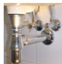
Eckreguliertventile unter einem Waschbecken
